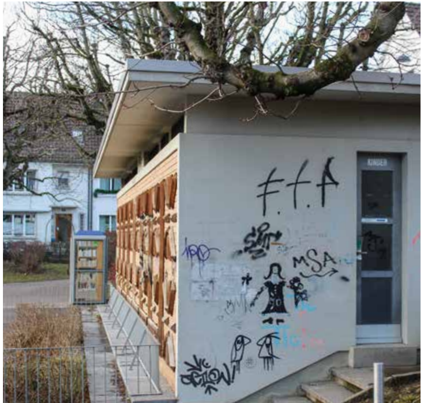
Diese Trafostation ist laut IWB unverzichtbar. Eine minimale Verkleinerung der Sperrfläche wäre zu prüfen.
